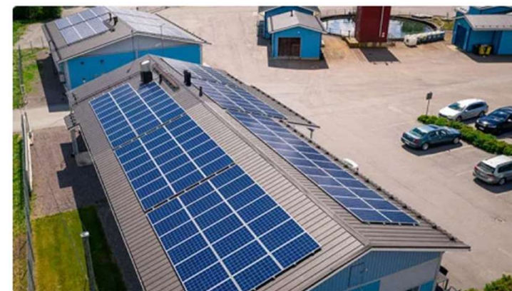
Kuva. Nivos Veden rakennusten katoilla on yhteensä 255 aurinkopaneelia.
