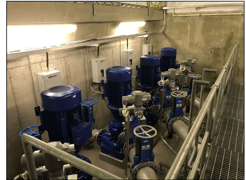
Kuva: Saneerattu pumppusali Veikkarin pumppaamolla.
