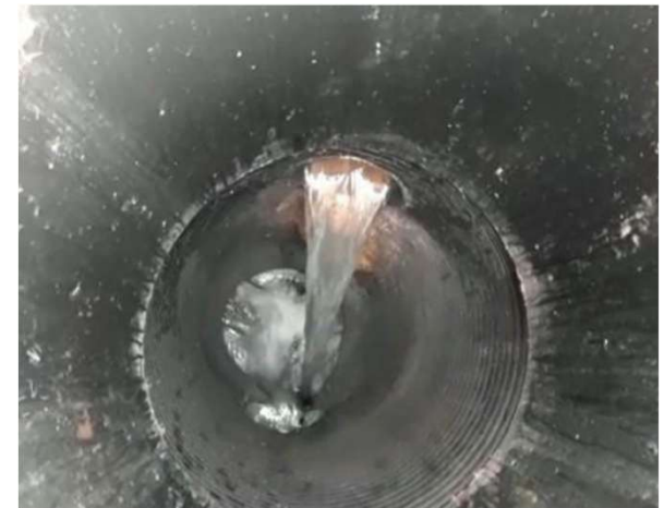
Kuva. Tarkastuskaivoon vuotaa ylivuotoputken kautta vettä viereisestä ojasta.
