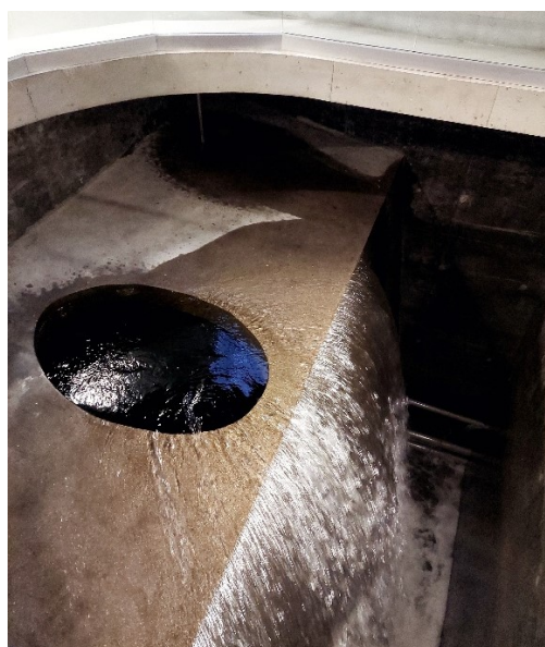
Kuva 18. MBR-permeaatin purkukaivo, Mipu.
