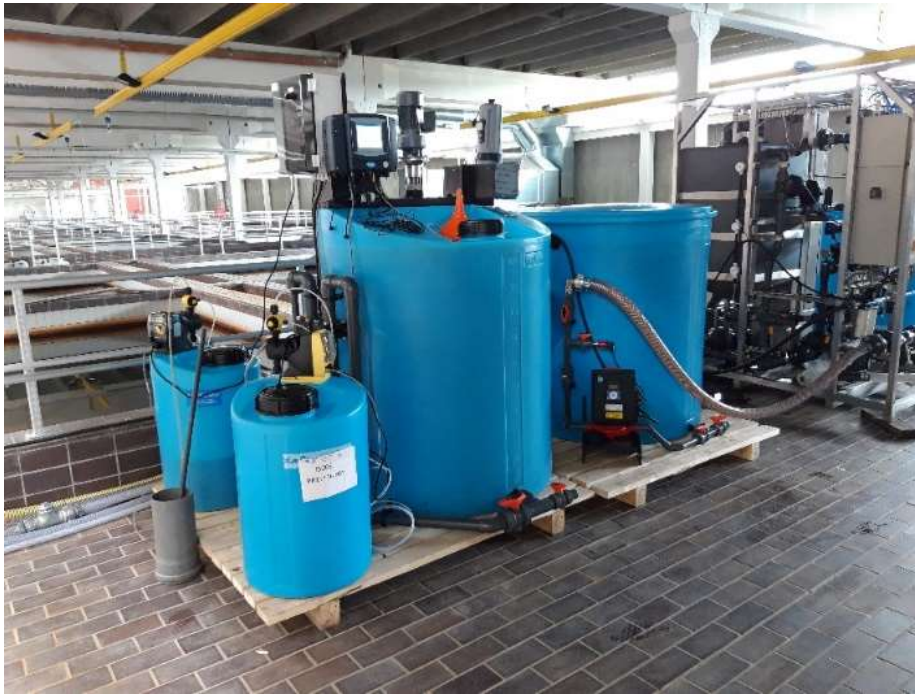
Kuva 9 Toinen pilotoinnissa käytetyistä esikäsittely-yksiköistä. Ensimmäisessä isossa säiliössä tapahtui flokkaus, toisesta vesi pumpattiin kalvosuodatukseen. Pienemmät säiliöt ovat kemikaalisäiliöt.
