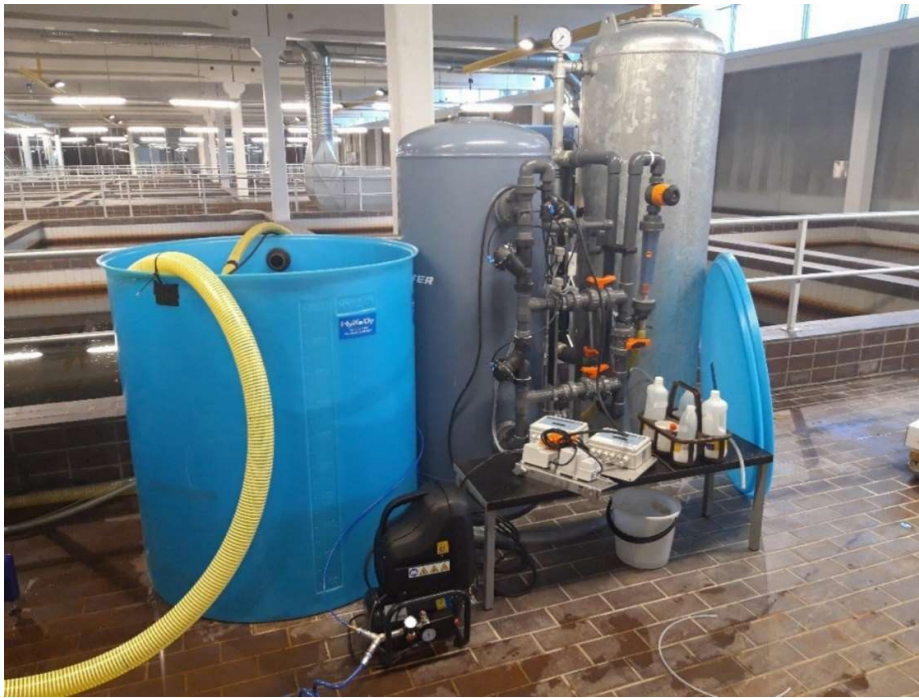
Kuva 11 Permeaattia käsittelevät jälkikäsitteilyn vaiheet. Vasemmalla on varastosäiliö, keskellä aktiivihiihluodatus ja oikealla kalkkikivisuodatus.
