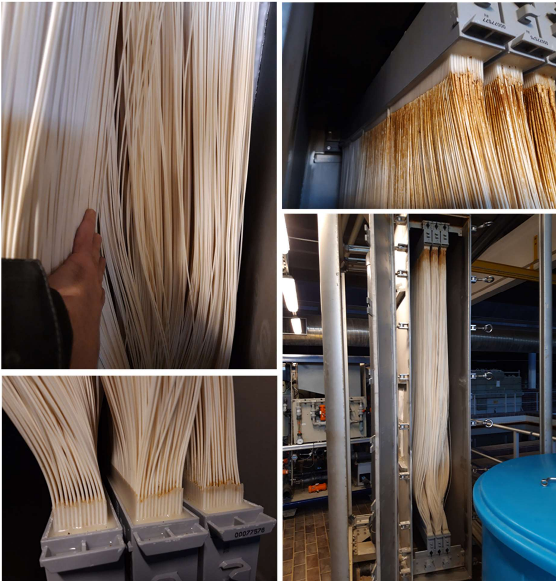
Kuva 22 ZeeWeed 500 -suodatuskalvon ontokuidut pysyivät kohtalaisen puhtaina suodatusjakson ajan. Kuitunippujen yläpäässä oli havaittavissa pientä kerrostumaa, mutta erityisesti keskivaiheilla kuitu oli täysin puhdas.
