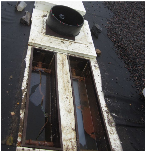
Kuva 10. Laskeutusaltaat ja niiden jälkeinen mittakaivo. Kuva: Heini Postila.
