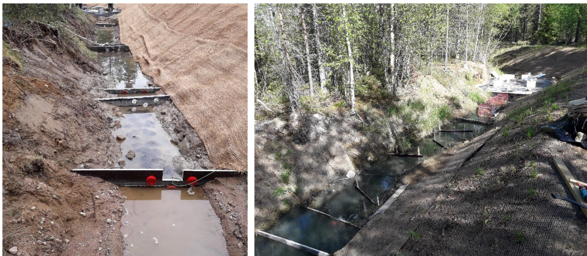
Kuva 30. Vasemmanpuoleisessa kuvassa sammalyksiköiden väliset vesivaneripatorakenteet nähtävissä ennen jäteveden johtamista ojastoon. Oikeanpuoleisessa kuvassa 7 m sammalyksikkö kesäkuussa 2020, kun siihen oli asennettu ohjauslevyt. Kuvat: Heini Postila ja Tuomo Reinikka.
