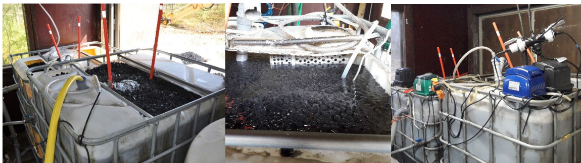
Kuva 29. Vasemmalla puolella olevassa kuvassa on säiliöihin toteutettu ilmastettu leijupetibioreaktori, keskimmaisessa kuvassa kesäkuun 2020 alussa pidennetty säiliön veden poistopään reikäputki ja raksut ja oikealla ilmapumput. Kuvat: Anne Korhonen ja Tuomo Reinikka.
