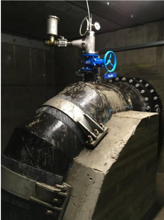
Kuva 17. 800 mm siirtolinja ja ilmanpoistoventtiili.
