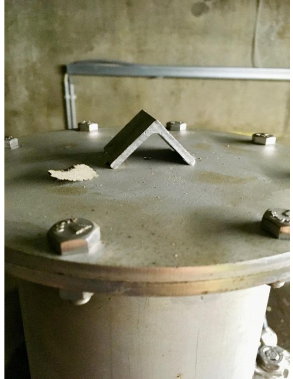
Kuva 18. Ilmanpoistoventtiilin pieni ilmanotto- ja poistoreikä näkyy läpän alla.
