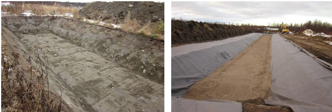
Kuva 2.1. Vasen) pajukosteikon pohja. Oikea) pajukosteikon pohjalle on asetettu hiekkakerros (0-6 mm hiekkaa 11 cm paksuudelta) ja reunoille N3-suodatinkangasta, joiden tehtävänä on suojata 1,5 mm HDPE-kalvoa, ettei se rikkoontuisi. (Kuvat: Heini Postila)
