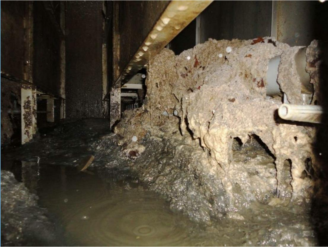
Kuva 14. Woffelsbachin MBR-laitoksella havaittu hienovälpeongelma (Kubota)
