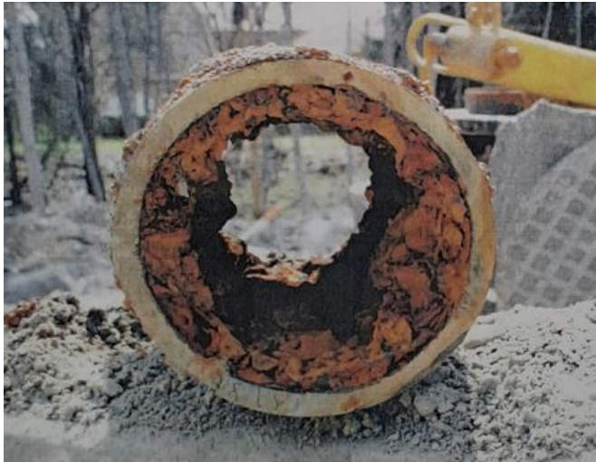
Kuva 21. Korroosion aiheuttamia syöpymiä valurautaputkessa. Kuva: Pekka Kaikkonen.
