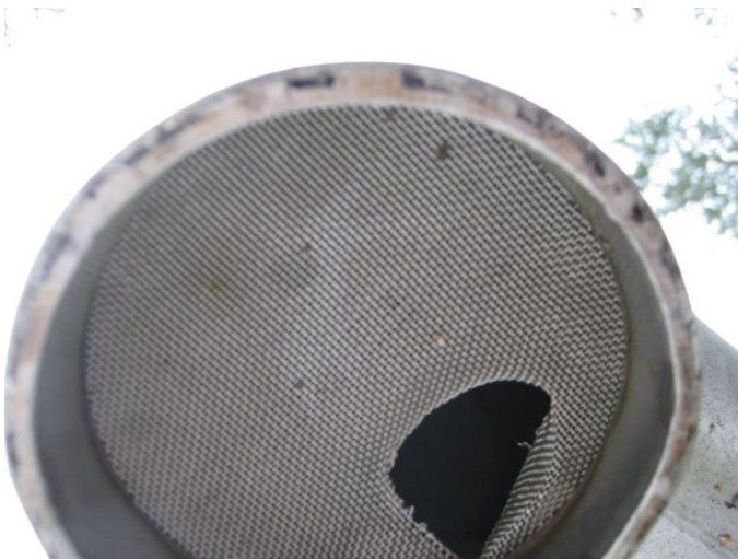
Kuva 23. Säiliöiden ja kaivojen tuuletusputkien pieneläinverkot pitää tarkistaa säännöllisesti.
