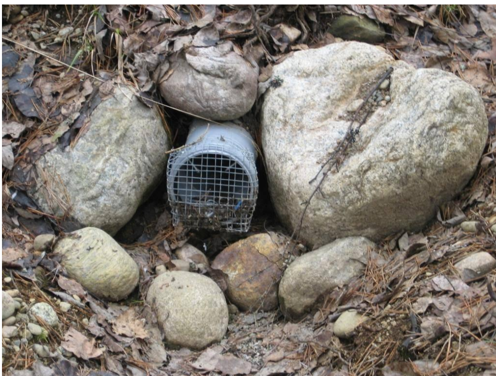
Kuva 11. Kaivoon voi virrata sulamis- ja tulvavesiä kuivatusputkea pitkin, jos takaisinvirtausta ei ole estetty. Kuvan suojaverkon silmäkoko ei ole riittävä estämään pieneläinten pääsyä kuivatusputkeen.
